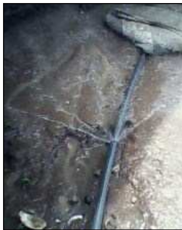
Figure 23: un autre tuyau cassé laissant couler l'eau potable dans une rue de pays bas. Janvier 2009. Photo : Beugre Stéphane. Copy Right : Pays bas-Gesco.
